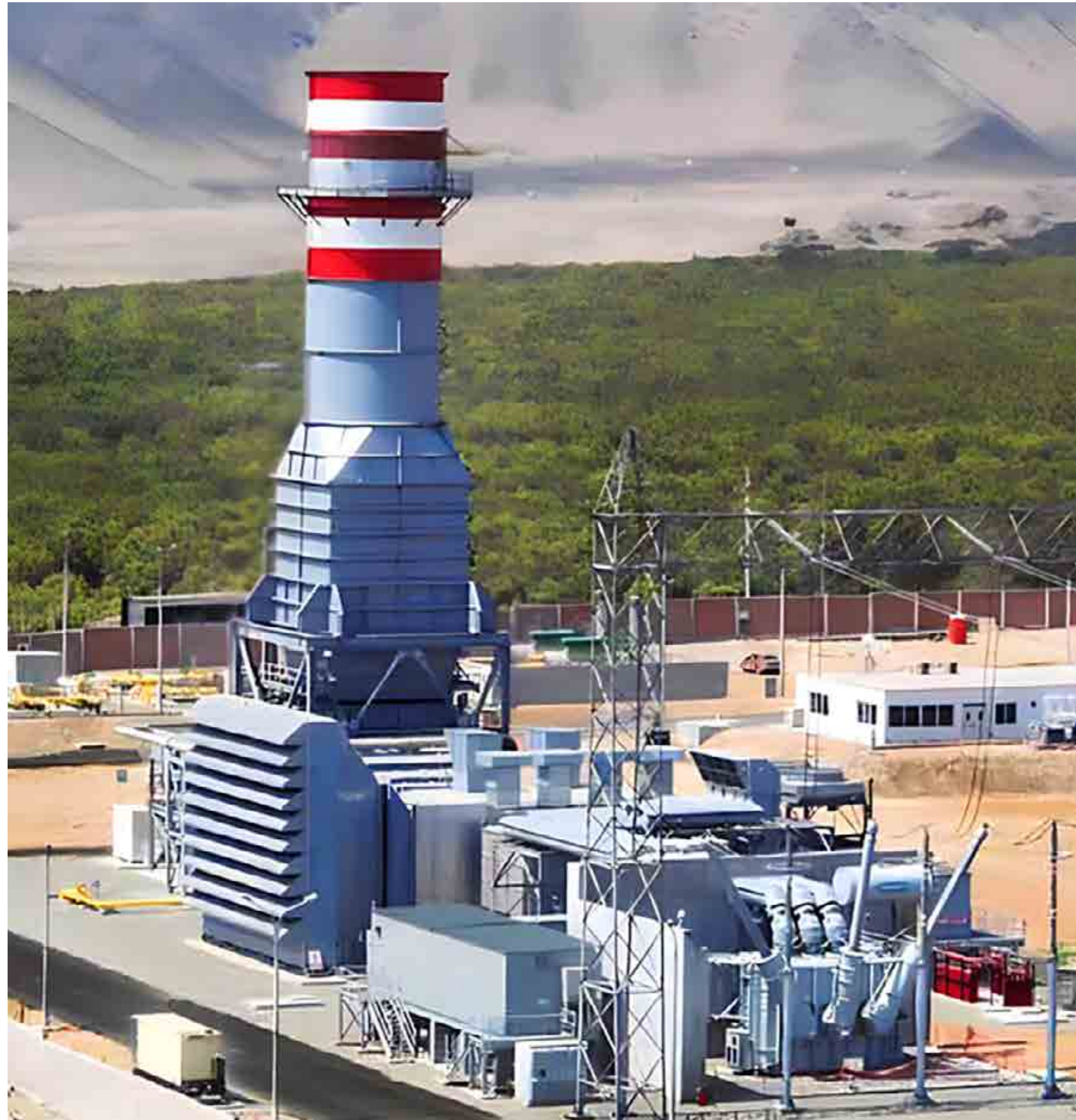
Central térmica Termochilca. Lima, Perú.
