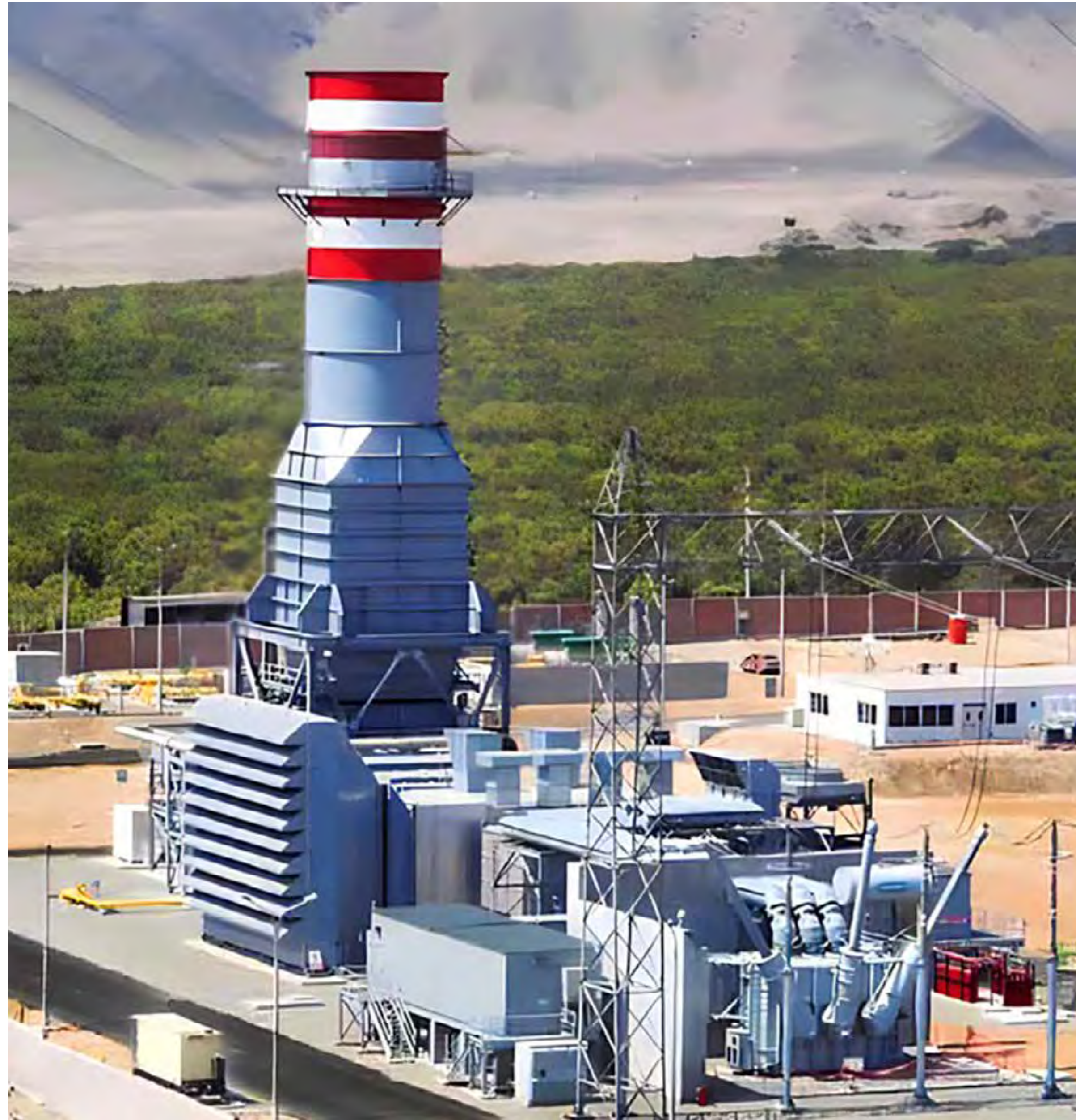
Central térmica Termochilca. Lima, Perú.
