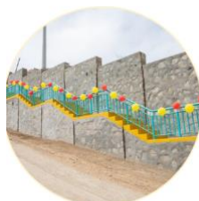
Muro de contención en Tablada de Larín, Villa María del Triunfo UT LIMA SUR
